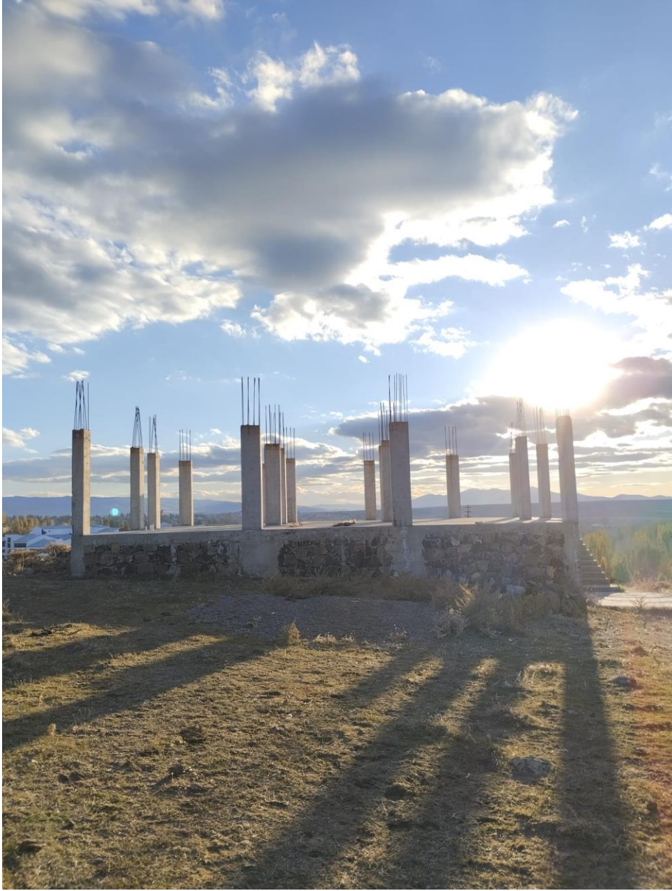
Fotoğraf 3: Alt Proje Alanındaki Ruhsatsız ve Tamamlanmamış Yapı
